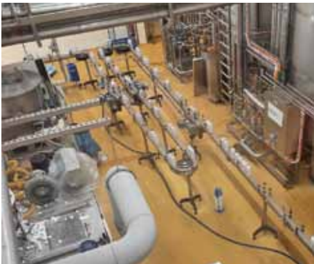
In hoch modernen Hallen kommt das, was die Kühe auf der Weide produzieren, in die Tüte. Von 23 Höfen wird hier die Milch verarbeitet.
